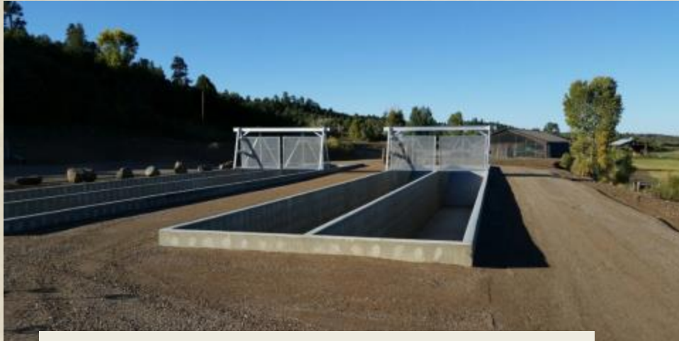
Los Ojos Sediment Particulate Vaults
